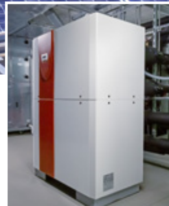
La nostra pompa di calore nell'edificio B.E.G.
